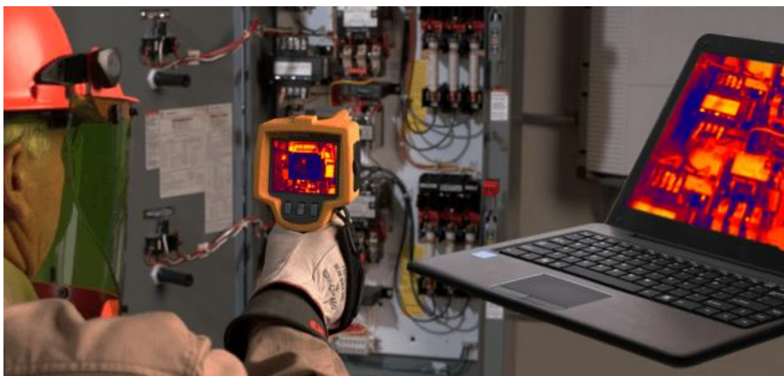
Рисунок 20. Пример проведения тепловизионного контроля электрошкафа
