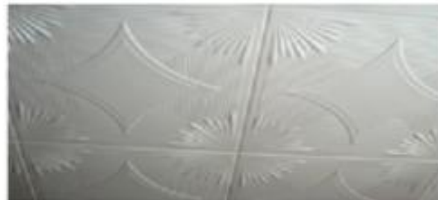
на потолочной плитке
